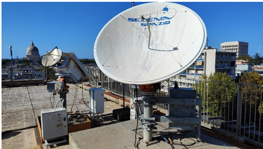
Figura 1 – Stazione ricevente Alphasat in banda Ka e Q, dislocata presso la sede Roma EUR del MIMIT. Sul lato sinistro si nota il ricevitore in banda Q, a destra quello in banda Ka
