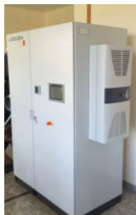
Sistema di accumulo sviluppato in collaborazione con Loccioni con batterie Litio (Hitachi Chemicals)
